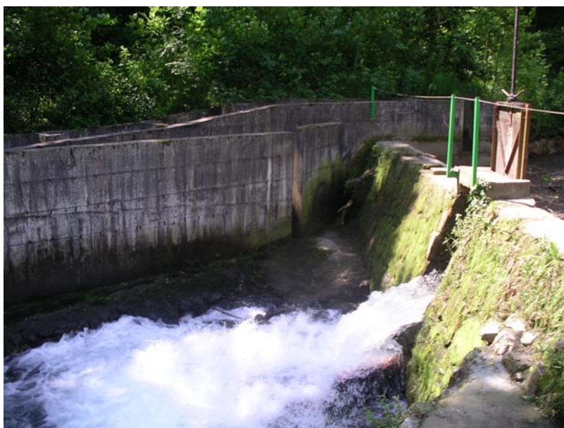
Foto 1. Regata Anizpe. Presa del Molino de Ubana. Municipio de Oitz. Concesión vigente para uso hidroeléctrico. Obstáculo difícilmente franqueable para la fauna piscícola.
