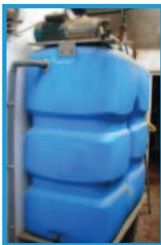
Depósito de 1000 litros con bomba
