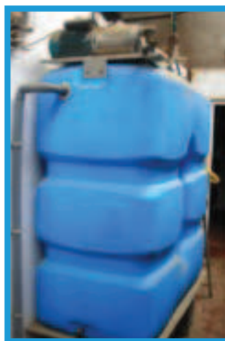
Depósito de 1000 litros con bomba
