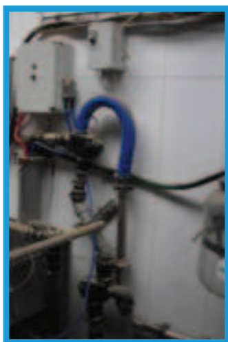
Set de control y Válvula de tres vías
